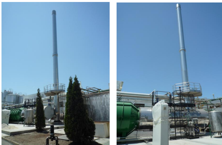
Figura 4 – Central de Oxidação Térmica
