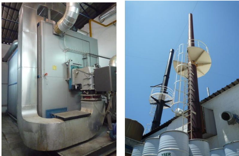
Figura 3 – Nova caldeira (CT3) a gás natural
